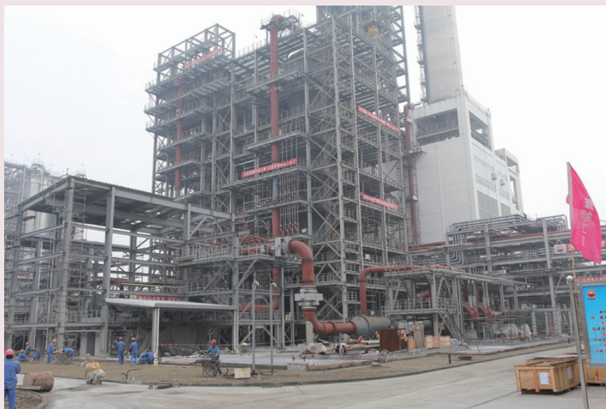
世界上单线生产能力最大的聚丙烯生产装置
